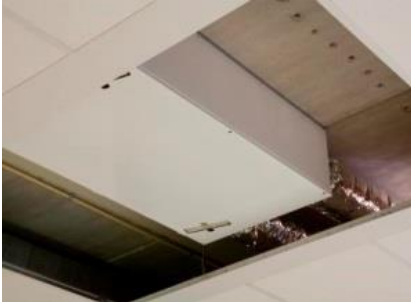
Umístění jednotek do podhledu
