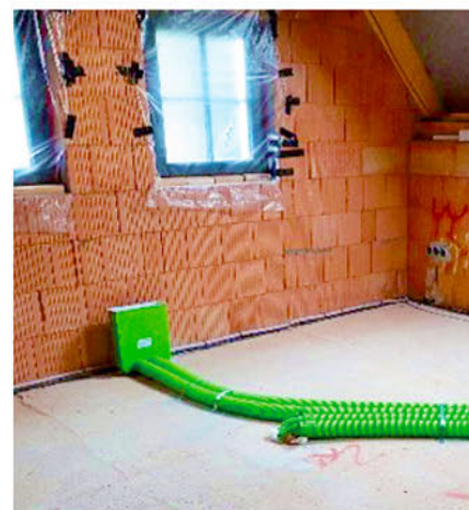
Vedení AE po stropě 1NP a přívod vzduchu podlahovou mřížkou a stropním ventilem
