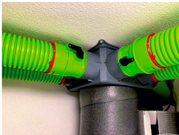
Regulační klapky na rozdělovacím DBoxu pro přesné nastavení průtoků vzduchu
