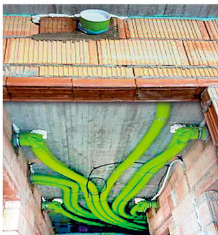
Vedení rozvodu AE v chodbě a přívod vzduchu skrz stěnu
