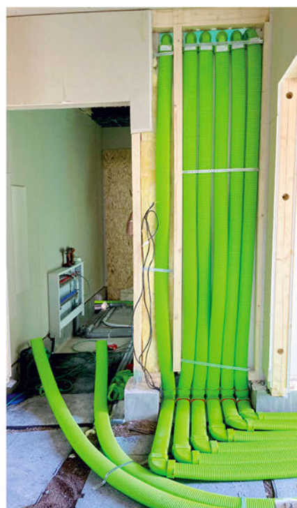
Přechod AE potrubí z podlahy do stěny a stropu
