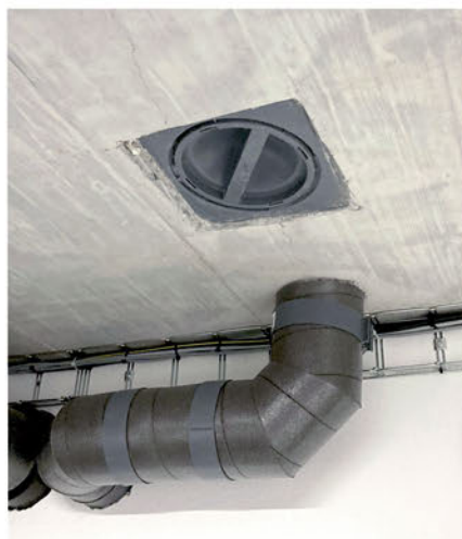
Rozdělovací boxy skryté v betonovém stropě.
