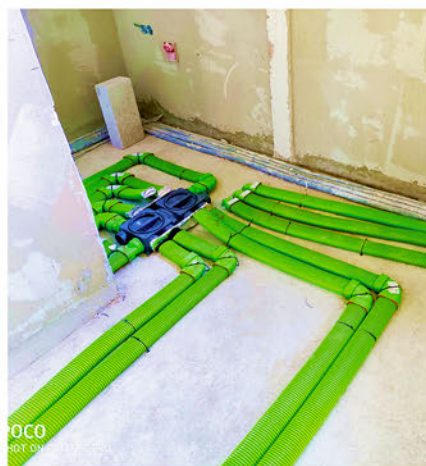
Ploché potrubí AE uložené v podlaze 2NP
