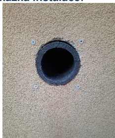
Potrubi s tepelnou izolací, např. Aerfoam
