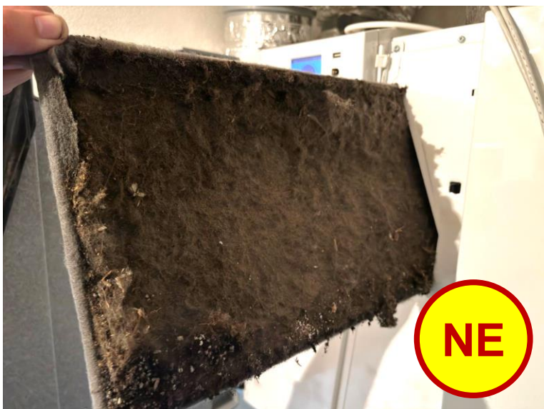
Příklad zanedbaného a znečištěného filtru, který vedl k nárůstu odporu až 280Pa !!
