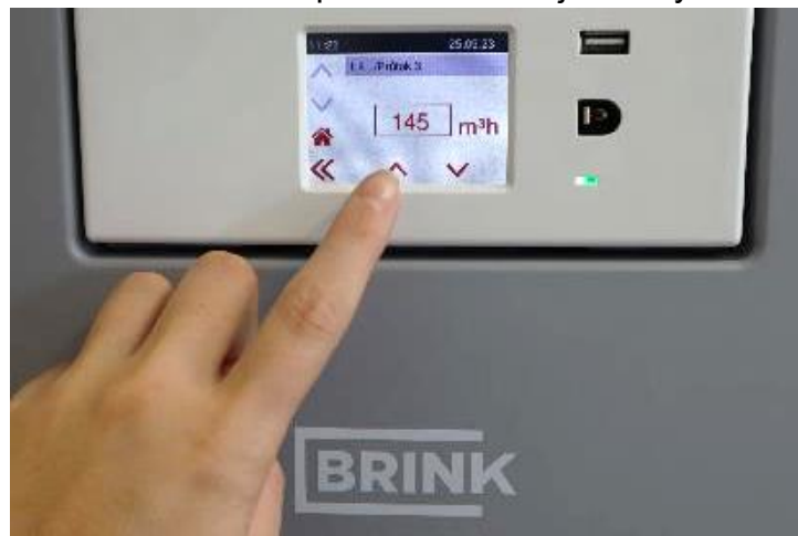
Nastavení průtoku větrací jednotky
